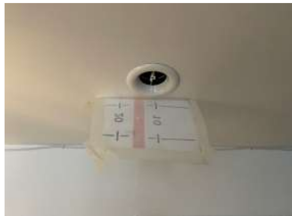
#4 Ventil demonteret for prøvetagning i spirorør.
