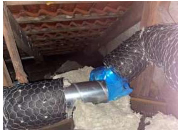
#2 Rørinstallationen er skilt ad i tagrum, for at imødegå kondens.
